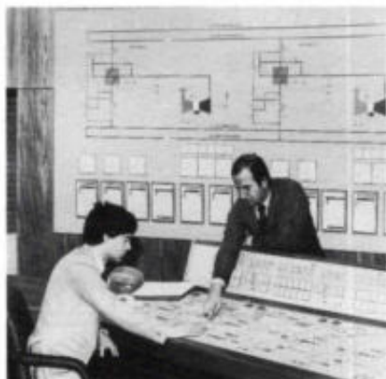
Inbedrijfstelling van meet- en regeltechniek voor de warmte/kracht centrale ROCA van het G.E.B. te Rotterdam.
